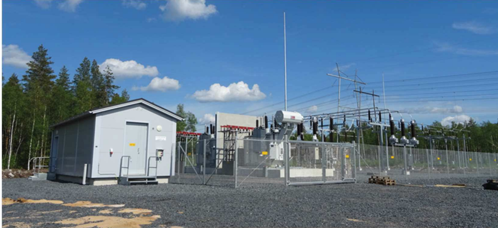
Kuva 10. Esimerkki tuulivoimapuiston sähköasemasta (Oltava, Pyhäjoki).
